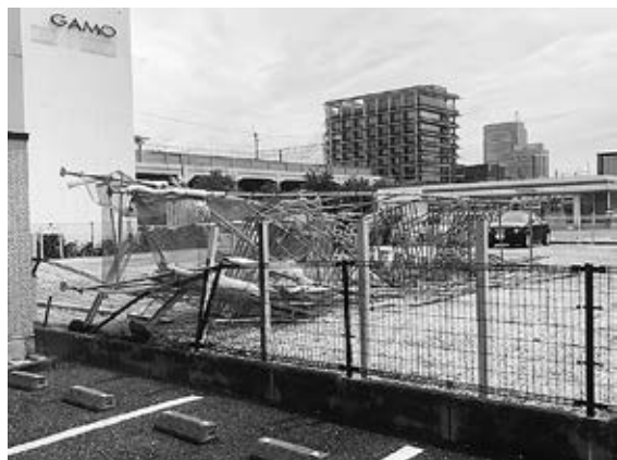
会館の工事足場が倒れる
