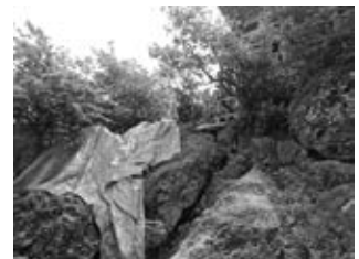
文殊堂に上がる岩場に被災の為、ブルーシートがかけられている (現在は迂回路を通って進む)
