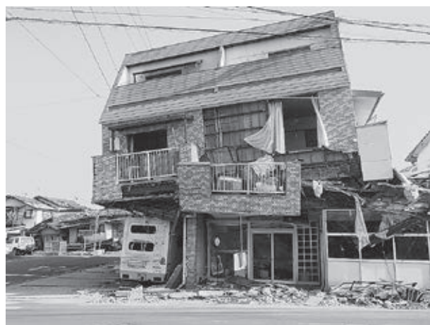
益城町木山 座屈建物
