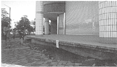
道路が落ちて入れないショッピングセンター
