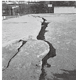
公園の走るひび割れ
